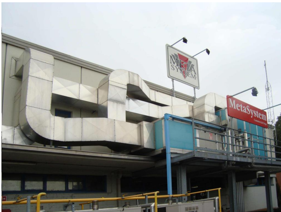
Figura 70 - Un esempio di installazione realizzata con canali in lamiera
