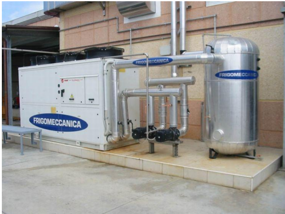
Figura 23 - Esempio di centrale frigorifera
