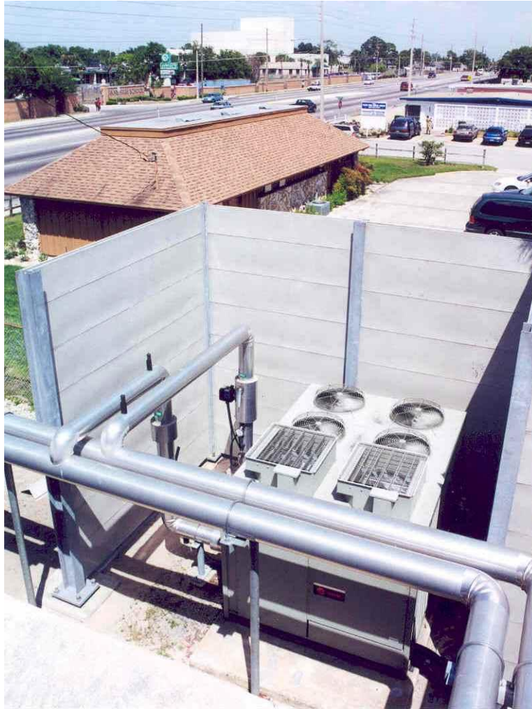
Figura 25 - Schermatura fono assorbente di una macchina frigorifera
